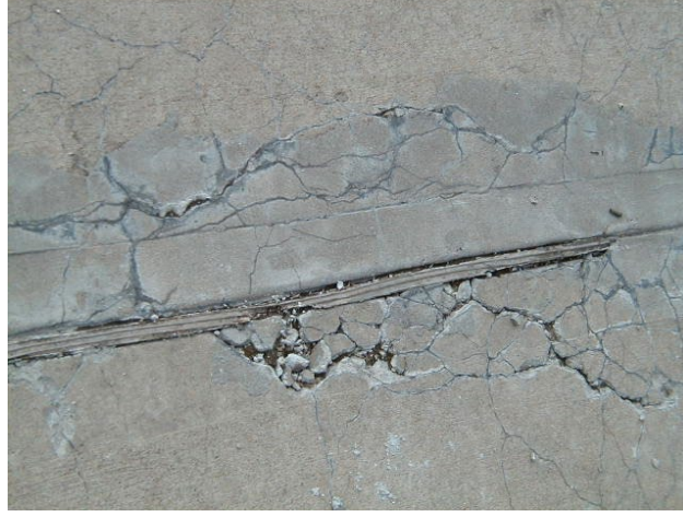
Şekil 5. Zemin betonunda D-çatlama oluşumu
