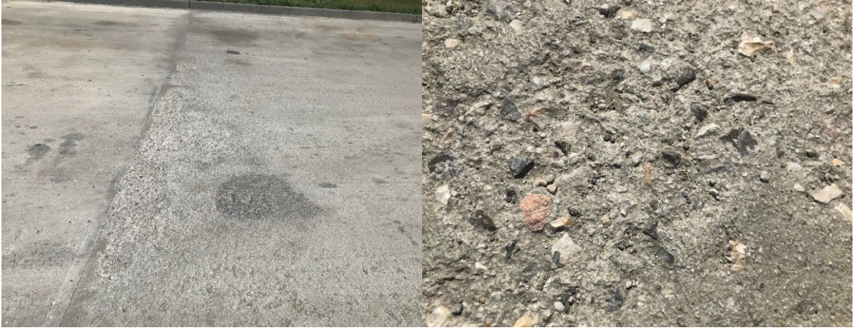
Şekil 4. Donma-çözülme nedeniyle beton yüzeyinde pullanma
