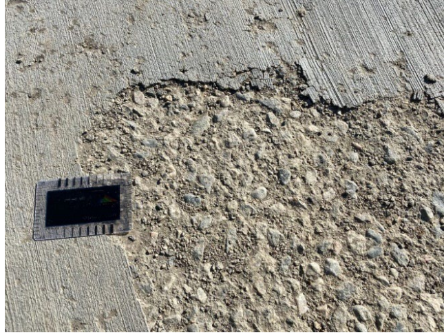
Şekil 6. Beton yüzeyinde kabuk atma
