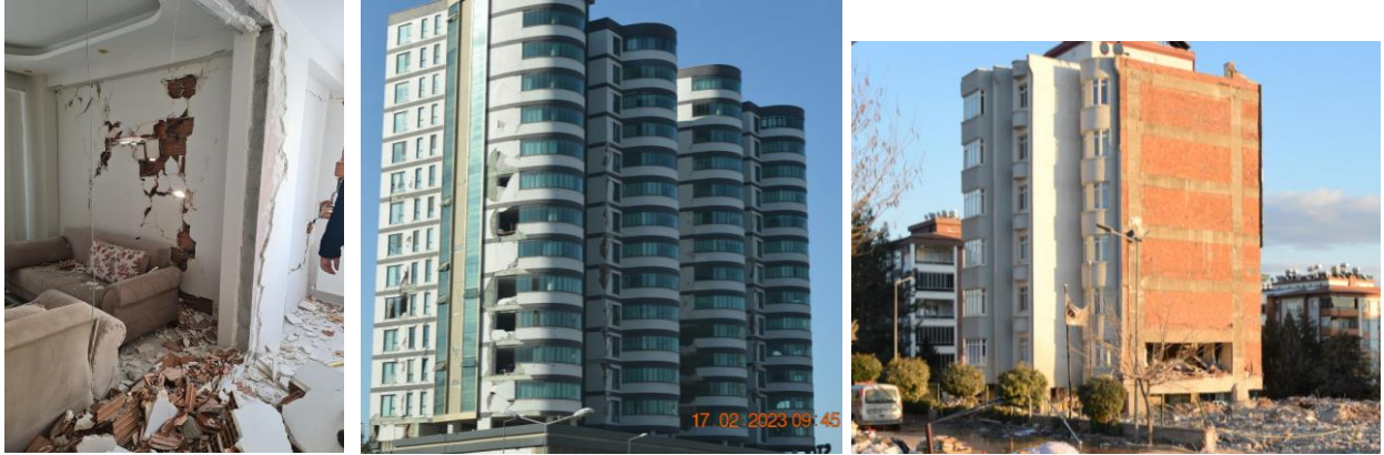
Şekil 5.8. Dolgu duvar hasarı örnekleri
