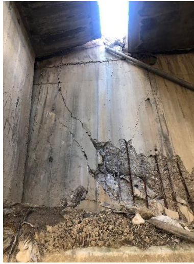
Şekil 6.7. Kenar ayak duvar kabuk dökülmeleri (eski ve yeni hasarlar birarada)
