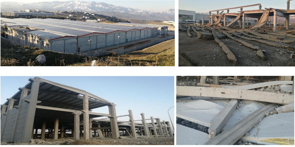
Şekil 5.6. Kahramanmaraş'ta önüretimli endüstriyel yapılarda bağlantı hasarlarına genel bakış
