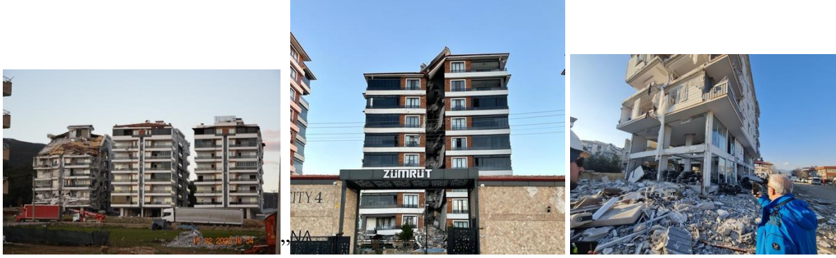
Şekil 5.4. Adıyaman ve İslahiye’de ağır hasarlı yeni binalar
