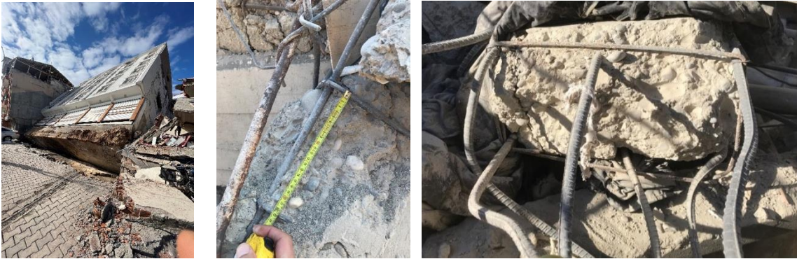
Şekil 5.3. Bina devrilmesi ve yetersiz birleşim bölgesi donatı detayı
