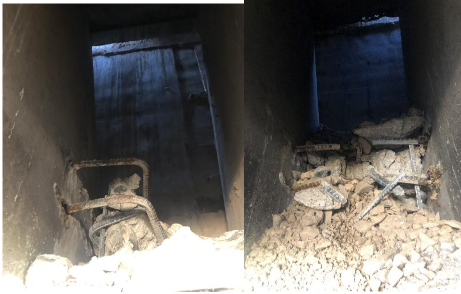
Şekil 6.6. Deprem takozu hasarı
