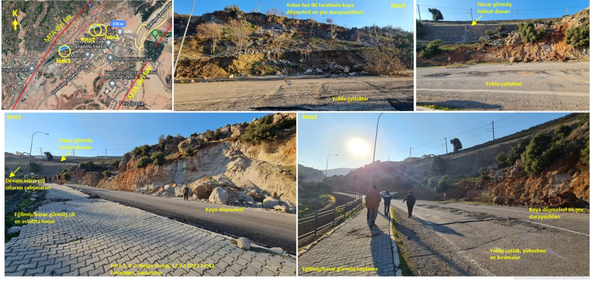
Şekil 8.9. Yolda yüzey çatlakları, kaya düşmesi, heyelan, istinat duvarında hasar ve devam eden yol onarımları. Fevzipaşa, Gaziantep yakını (fay verisi Emre vd. (2013)'den alınmıştır).
