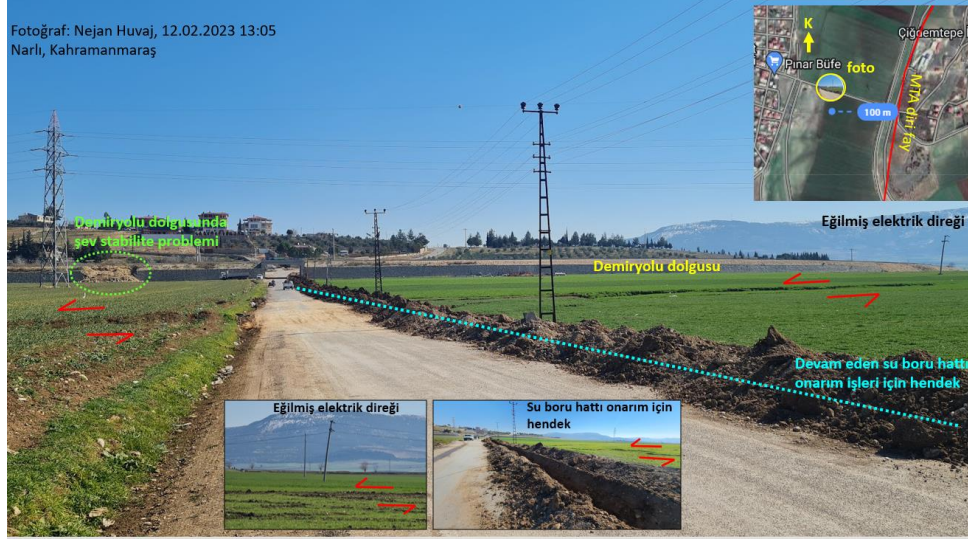
Şekil 8.3. Fotoğrafların çekildiği yerler için Şekil.8.2'ye bakılabilir: fay yüzey kırığı/yanal atım nedeniyle yolda ofset, demiryolu dolgusunda şev stabilitesi problemi, su boru htında onarım işlemleri için açılan hendek, eğilmiş bir elektrik direği. Narlı, Kahramanmaraş yakını (fay verisi Maden Tetkik ve Arama Genel Müdürlüğü yayını olan Emre vd. (2013)'den alınmıştır).
