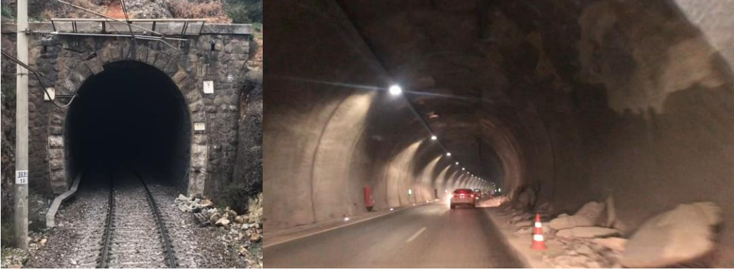
Şekil 6.9. Tünel portal deformasyonları ve tünel içi kabuk dökülmesi
