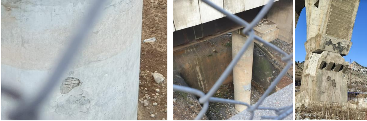
Şekil 6.3. Kolon paspayı ve kabuk dökülmesi
