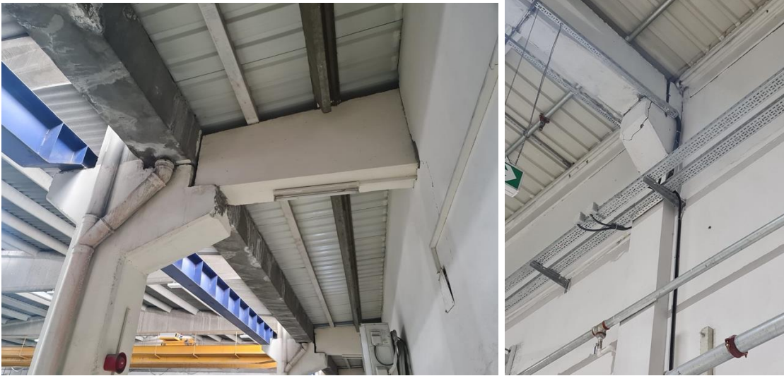
Şekil 5.7. Gaziantep'te kısa konsol (guse) hasarları
